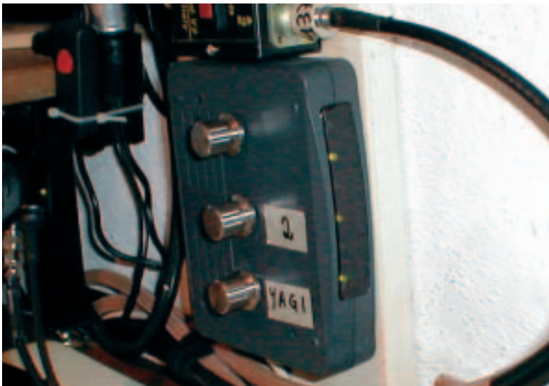
foto 5: comando montato in stazione
